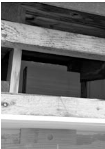
Fledermauskasten mit herausragendem Anflugbrett für die Fledermäuse, welches die Fassade schützt.
