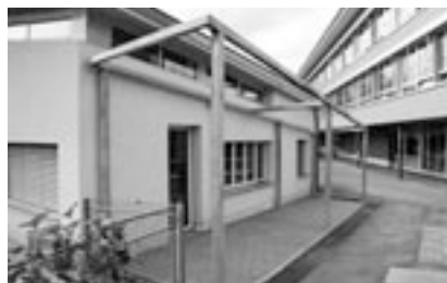
Stahlkonstruktion für die Bepflanzung und den Boden des Grünen Schulzimmers. Die Bepflanzung wird im Herbst vorgenommen.
