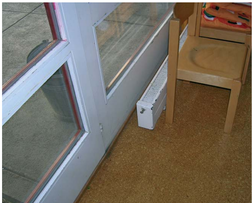
Die 30 bis 40 Jahre alten Fenster sind undicht und sollen ersetzt werden.
