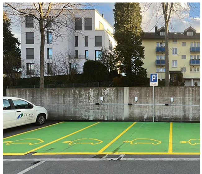
Ladestationen für E-Autos auf dem Parkdeck Hofmatt.
