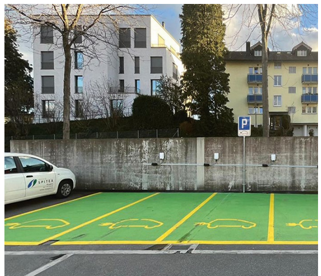
Ladestationen für E-Autos auf dem Parkdeck Hofmatt.
